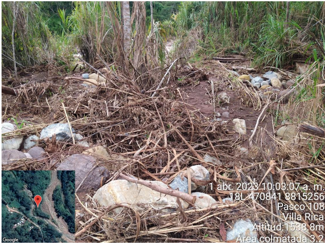
Fotografía 7. Colmatación del río en el Área 3.2.
