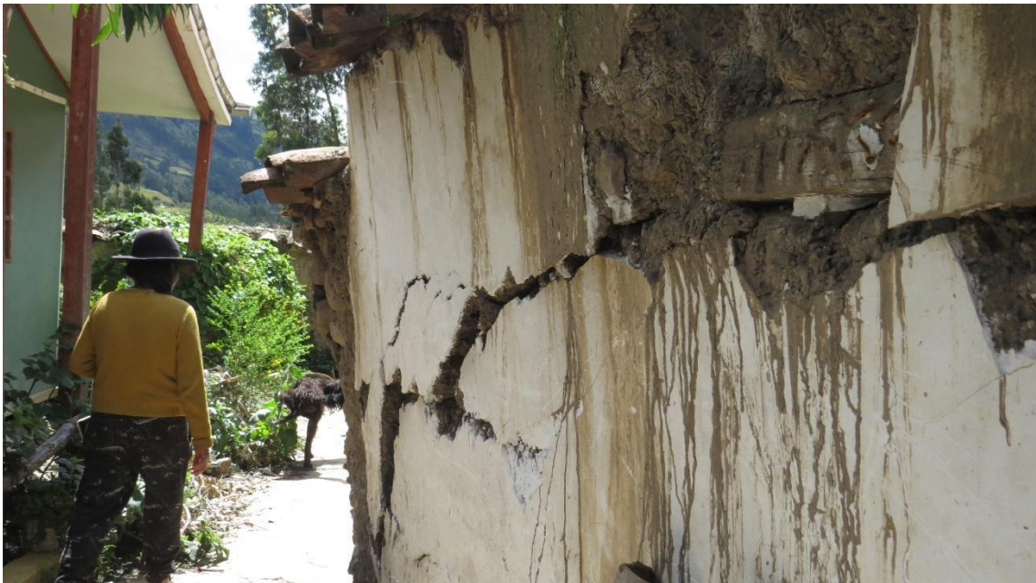
Fotografía 5: Vivienda colapsada con múltiples grietas en las paredes.
