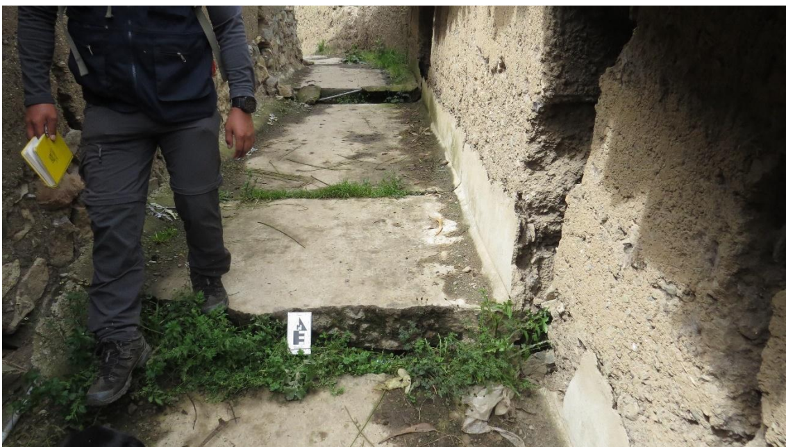
Fotografía 7: Múltiples grietas en el suelo y paredes de las viviendas, además, se observan saltos en las veredas que inicialmente eran de un solo nivel.
