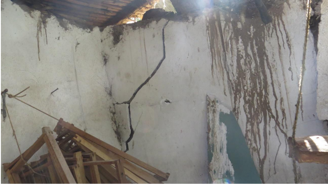
Fotografía 4: Vivienda colapsada con múltiples grietas en las paredes.
