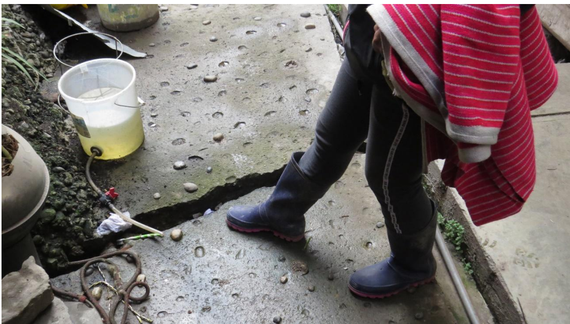
Fotografía 6: Grietas en el terreno, evidencia de desplazamiento y afectación a las viviendas del Caserío Millhuish.
