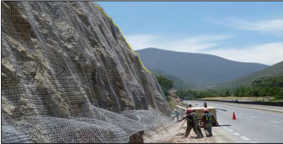
Figura 39. Mallas de protección con anclajes para caída de rocas o derrumbes tanto en detritos como roca alterada, (Vilches, 2021)
