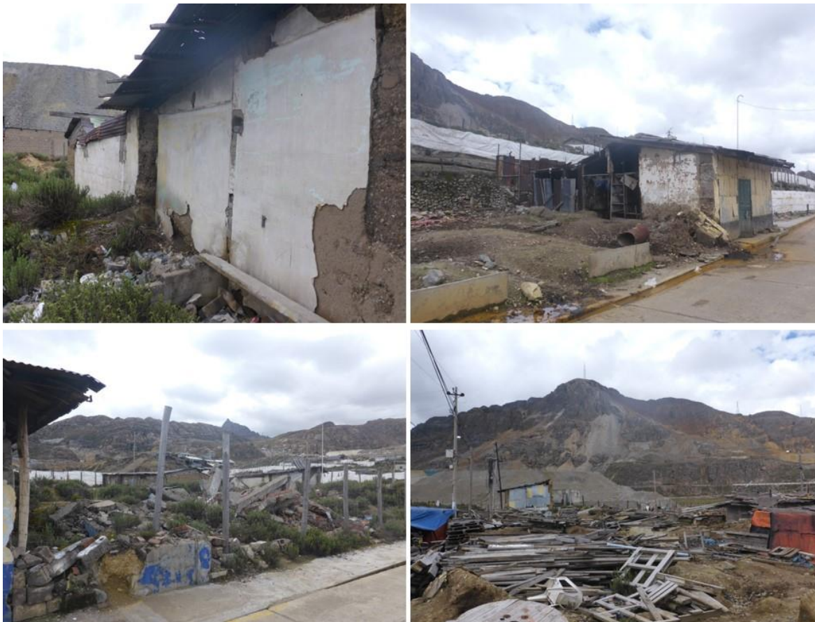
Figura 5. Las viviendas que se encuentran ocupadas en la actualidad suman un total de nueve, las cuales albergan familias, dichas viviendas presentan grietas frontales, laterales y muros a punto de colapsar, las demás viviendas de Morococha antigua se encuentran destruidas.
