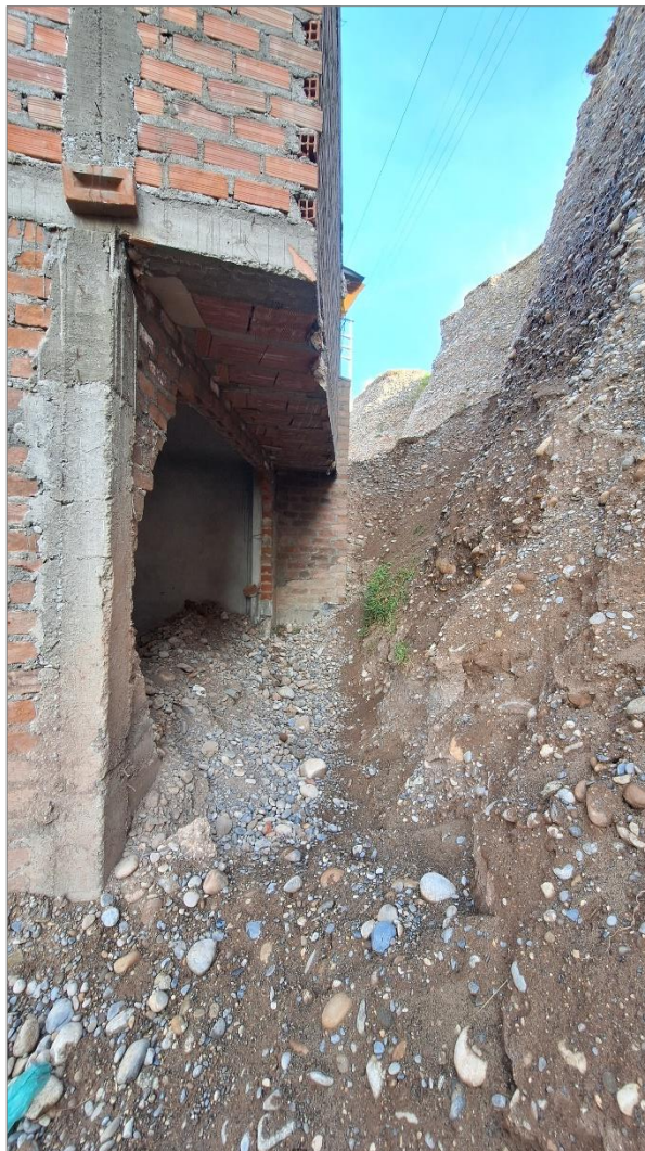
Fotografía 4. Vista del derrumbe producido en agosto del año 2023.
