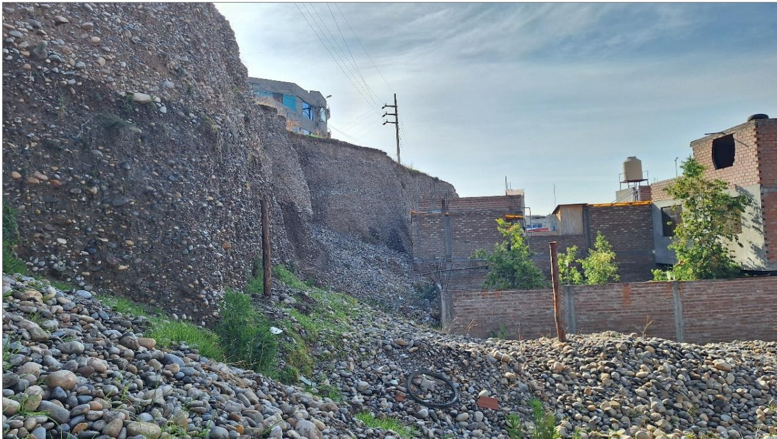
Fotografía 1. Depósito coluvial dispuesto al pie del talud verticalizado, compuesto por gravas mal clasificadas.
