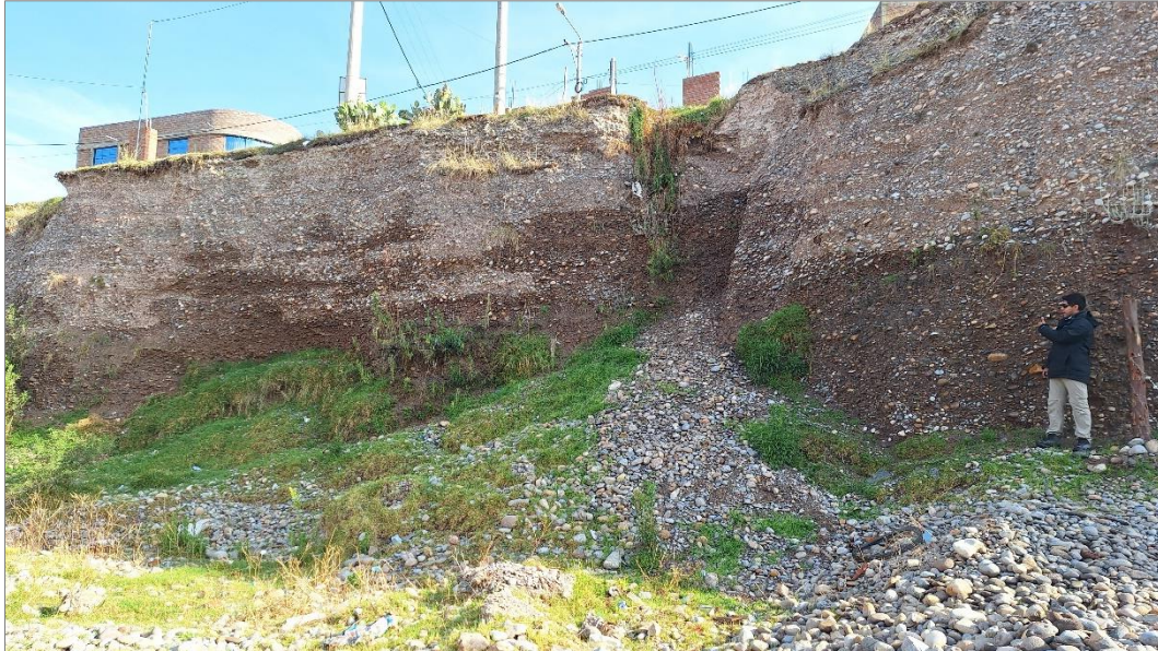
Fotografía 3. Vista del derrumbe producido en el talud verticalizado de 85°.
