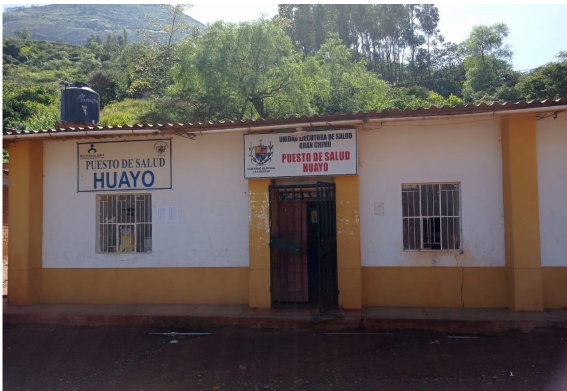
Fotografía 4: Afectación del puesto de salud “Huayo”, influenciados por el avance retrogresivo del deslizamiento activo DA-01. Fuente: Municipalidad Distrital de Lucma, 2024.
