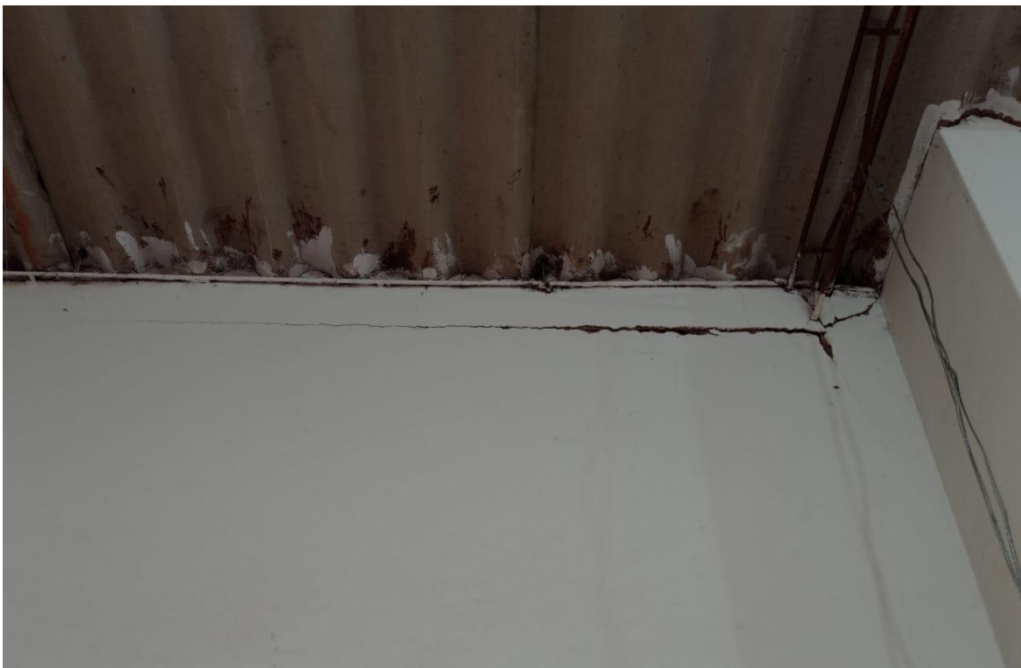
Fotografía 2: Grietas en paredes y columna, cerca al deslizamiento activo DA-01. Fuente: Municipalidad Distrital de Lucma, 2024.
