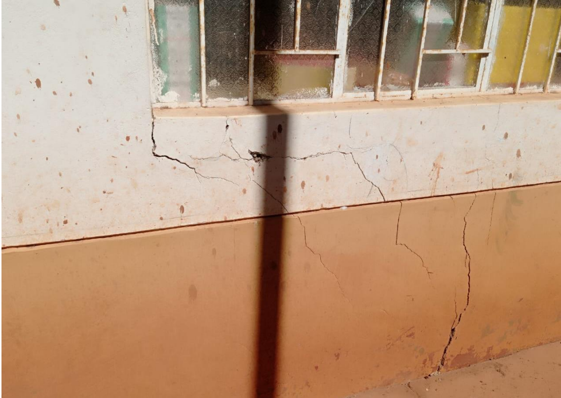
Fotografía 1: Grietas en paredes del puesto de salud del centro poblado “El Huayo”, posiblemente influenciados por el avance retrogresivo del deslizamiento activo DA-01. Fuente: Municipalidad Distrital de Lucma, 2024.
