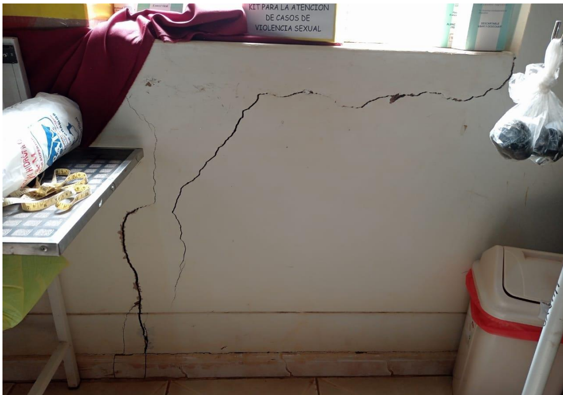
Fotografía 3: Grieta en pared, posiblemente dispuestas en dirección paralela a la escarpa principal del deslizamiento activo DA-01. Fuente: Municipalidad Distrital de Lucma, 2024.
